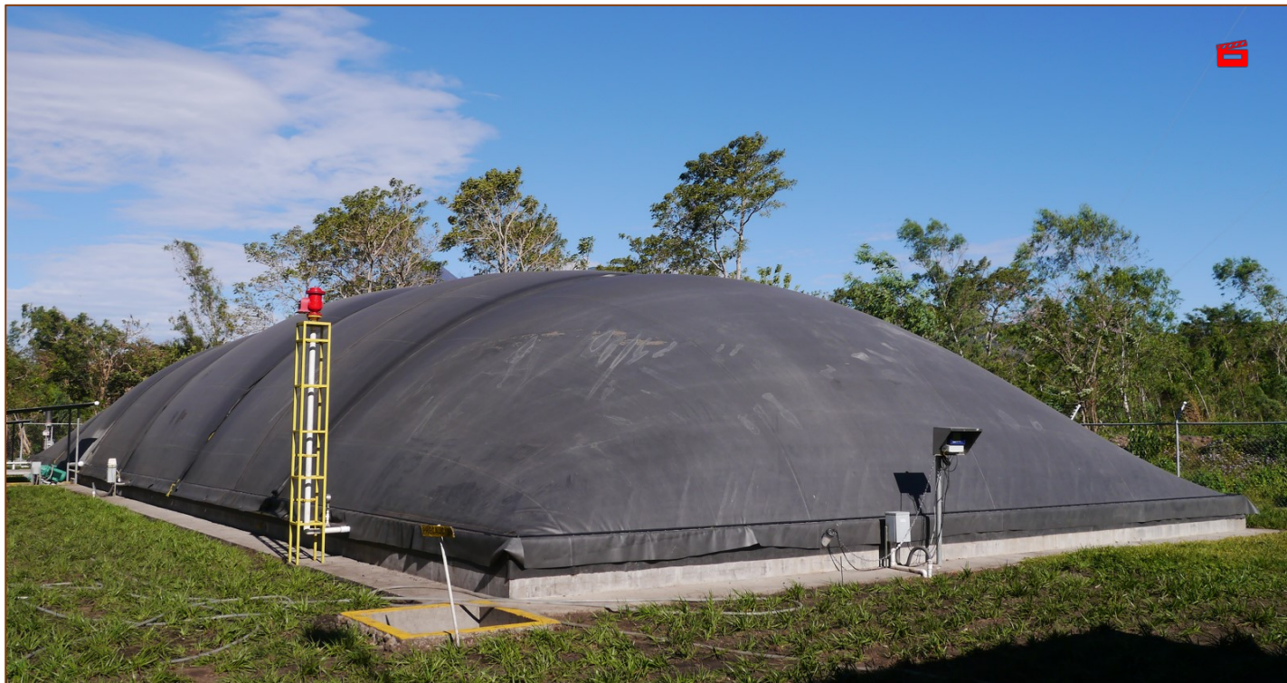
Biodigestor en fabrica de lácteos
