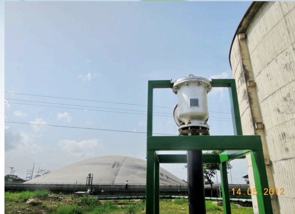
Válvula de seguridad en biodigestor en Venezuela
