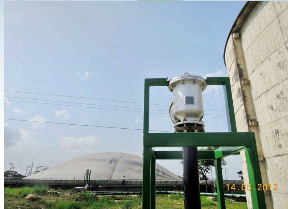
Válvula de seguridad en biodigestor en Venezuela
