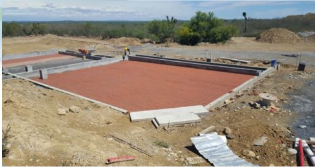
LECHO DE SECADO DE LODOS
